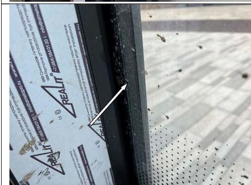
Фото №24. Дефект остекления (однокамерным, вместо двухкамерного) стеклопакетом оконного блока в помещении № 1.
