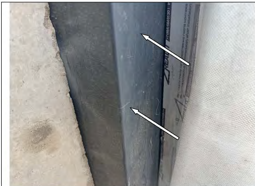
Фото №13. Царапины на металлическом профиле оконного блока в Помещении № 4.
