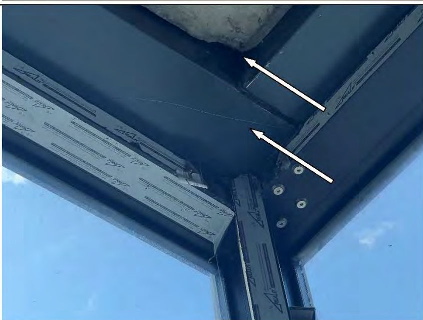
Фото №12. Щель в стыке примыкания рамы оконного блока и железобетонной стены в помещении №4. Царапины на металлическом профиле оконного блока в Помещении № 4.
