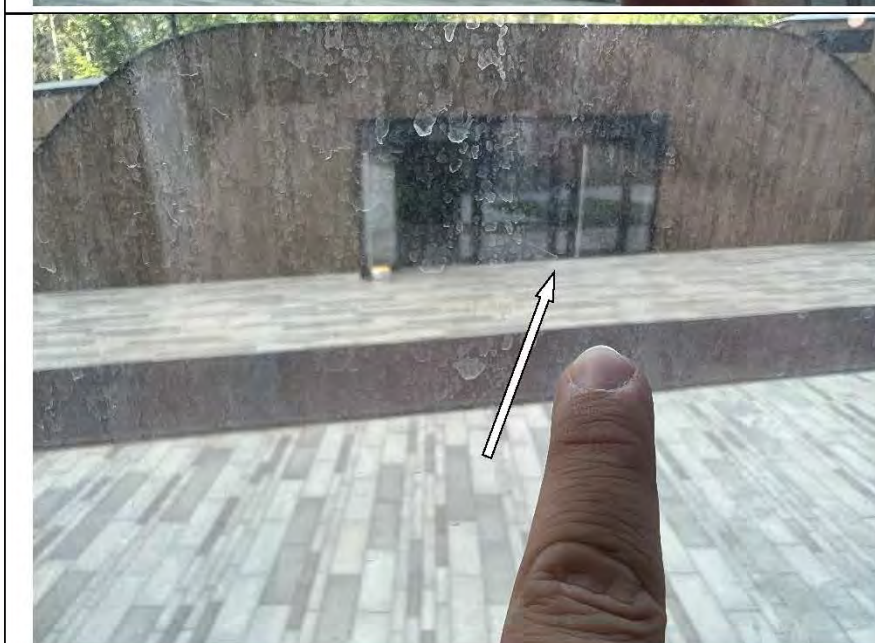
Фото №18. Царапины на стеклопакете металлического оконного блока в помещении № 4.
