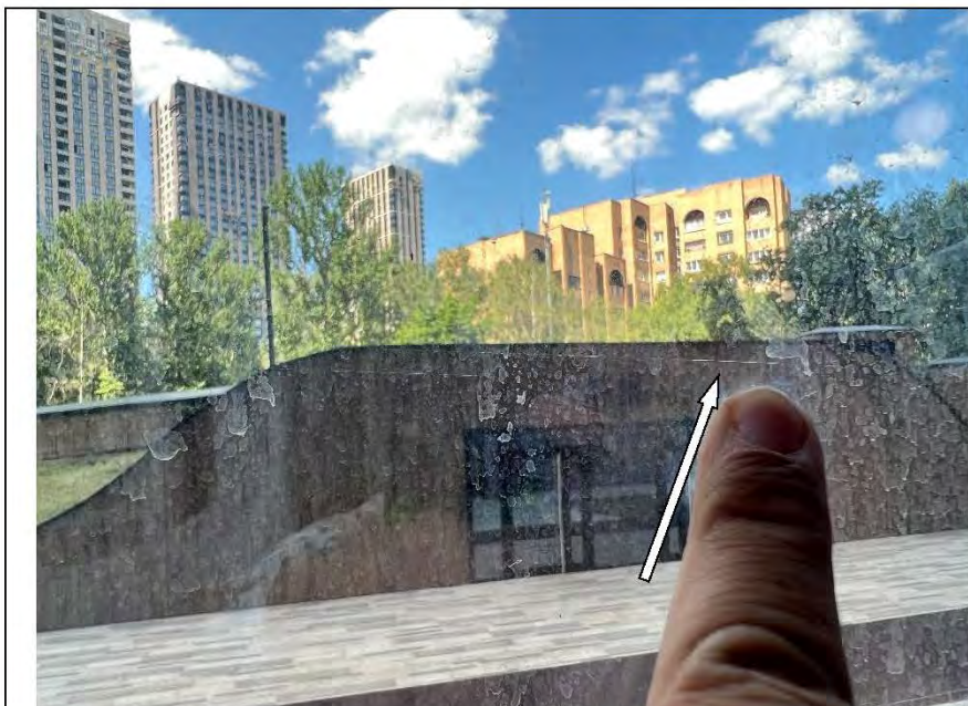
Фото №16. Царапины на стеклопакете металлического оконного блока в помещении № 4.
