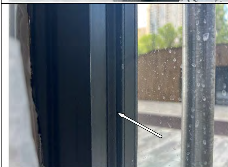
Фото №27. Дефект остекления (однокамерным, вместо двухкамерного) стеклопакетом дверного блока в помещении № 5.
