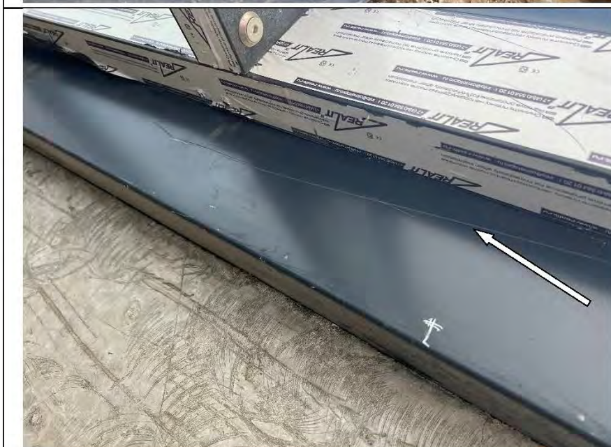
Фото №15. Царапины на металлическом профиле оконного блока в Помещении № 4.
