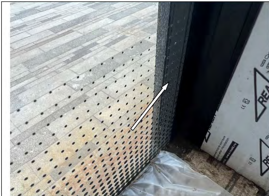
Фото №25. Дефект остекления (однокамерным, вместо двухкамерного) стеклопакетом оконного блока в помещении № 4.
