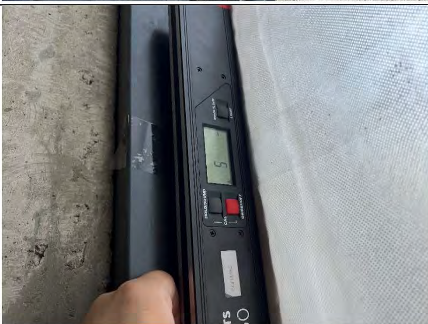
Фото №21. Отклонение металлического оконного блока по уровню вертикальности в помещении №1 равняется 5 мм.
