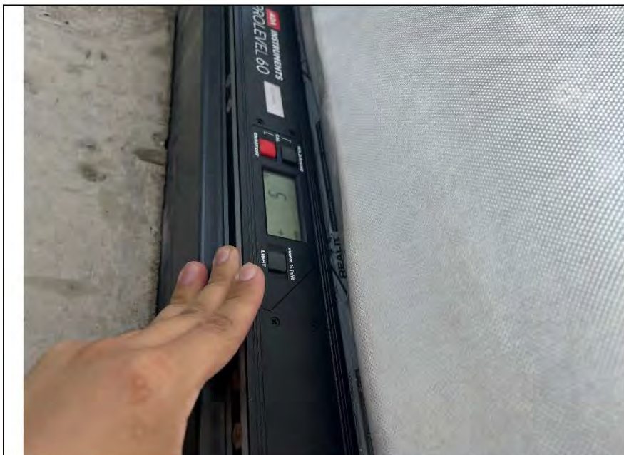
Фото №22. Отклонение металлического оконного блока по уровню вертикальности в помещении №4 равняется 5 мм.
