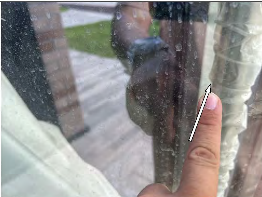
Фото №19. Царапины на стеклопакете металлического дверного блока в помещении № 5.
