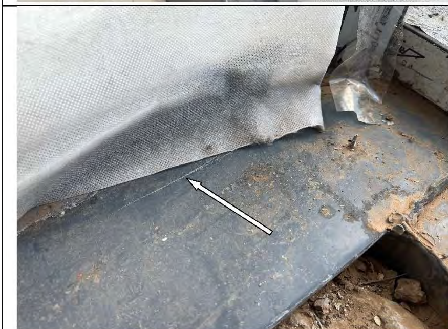
Фото №14. Царапины на металлическом профиле оконного блока в Помещении № 4.
